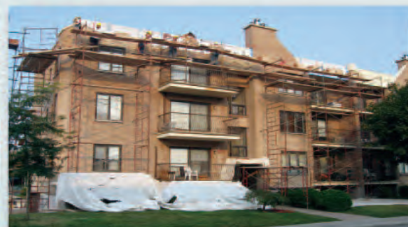
SYNDICAT COPROPRIÉTÉ 310 LOUISE LAMY Réparations d'importantes infiltrations d'eau à l'immeuble
