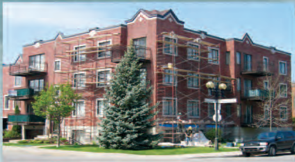
SYNDICAT COPROPRIÉTÉ DU 3479 WILLIAM TREMBLAY Réparations d'importantes infiltrations d'eau au dessus plusieurs fenêtres et à la base des murs de briques
