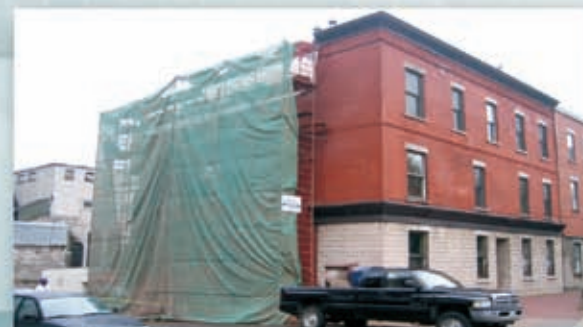
SYNDICAT DES COPROPRIÉTAIRES DU 2030 ST-ANTOINE OUEST Reconstruction des sections des murs de briques avec des ventres de bœuf
