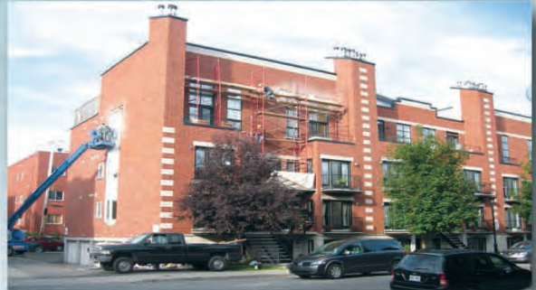
SYNDICAT DES COPROPRIÉTÉ HENRI-DESLONGCHAMPS Réparations d'importantes infiltrations d'eau à l'immeuble
