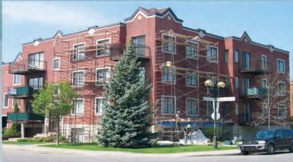
SYNDICAT COPROPRIÉTÉ DU 3479 WILLIAM TREMBLAY Réparations d'importantes infiltrations d'eau au dessus plusieurs fenêtres et à la base des murs de briques
